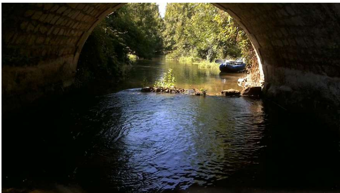
Photo 59 : Pont communal sur la Seugne au lieu-dit « Jarlac » (vue depuis l'amont)
